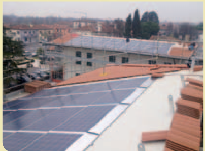
Il risultato degli interventi fatti sui tetti del Centro Culturale, della Scuola elementare di Resana e della relativa palestra
