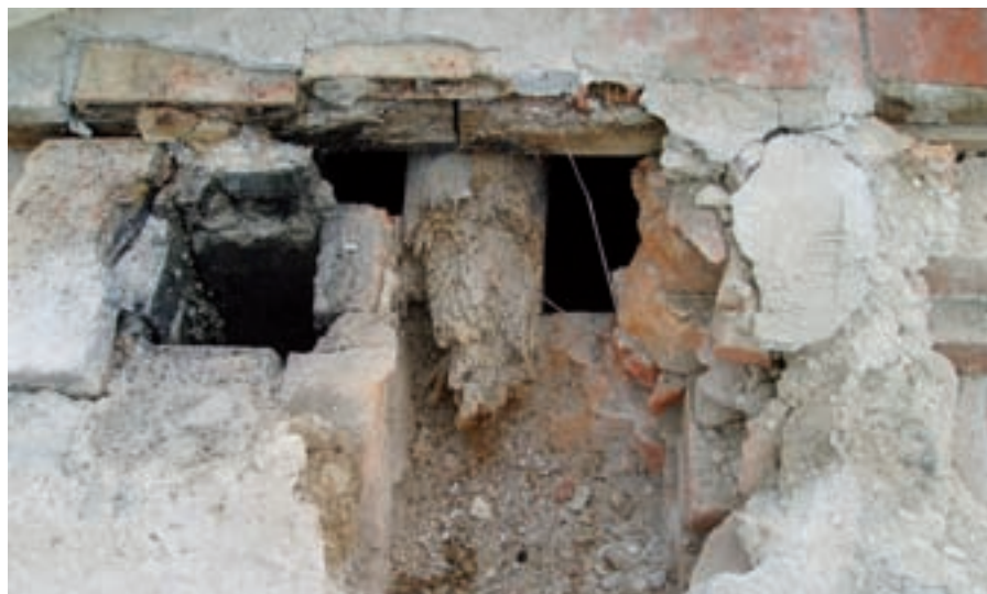
Vecchia travatura... teneva per miracolo!
